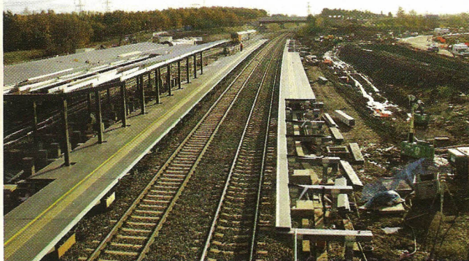
Installation des quais de la nouvelle gare d'East Midlands Parkway, au début de l'hiver 2008-2009.
